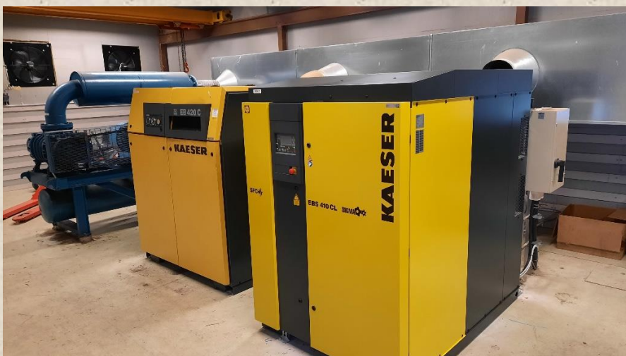
Puhdistamon biovaihe 2 uusi pääilmastuskompressor
