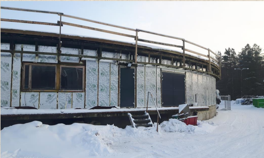
Rakennus 2 ulkoseinät ja sokkeli lämpöeristeineen samoin kuin käyntiovet ja ulkoportaot uusittiin. Turhat lastaussillat poistettiin.
